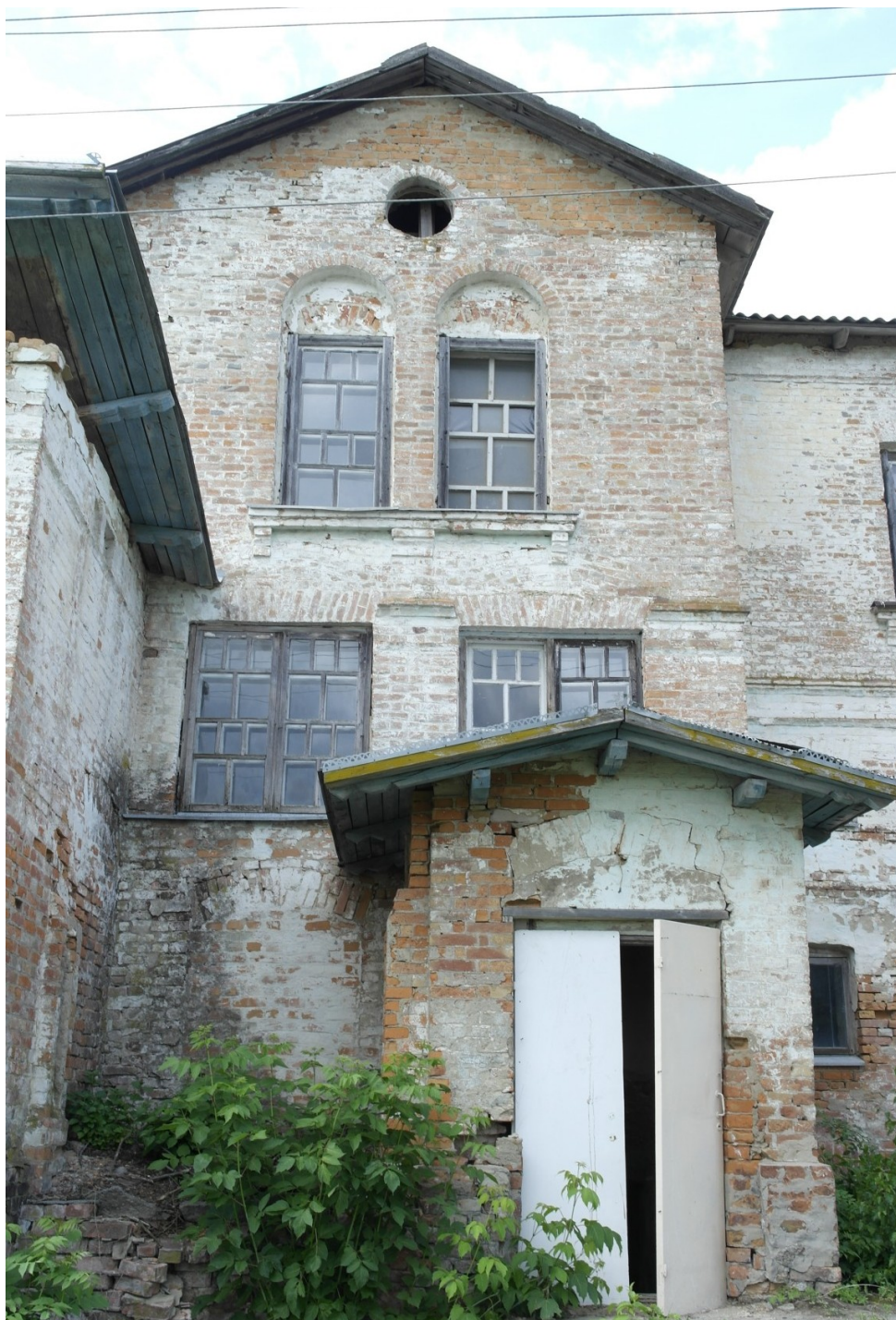
Рис. 15. Мала Клітинка, палац з півдня. Вхід до підвалу прибудови, видно закладені вікна першого поверху.
